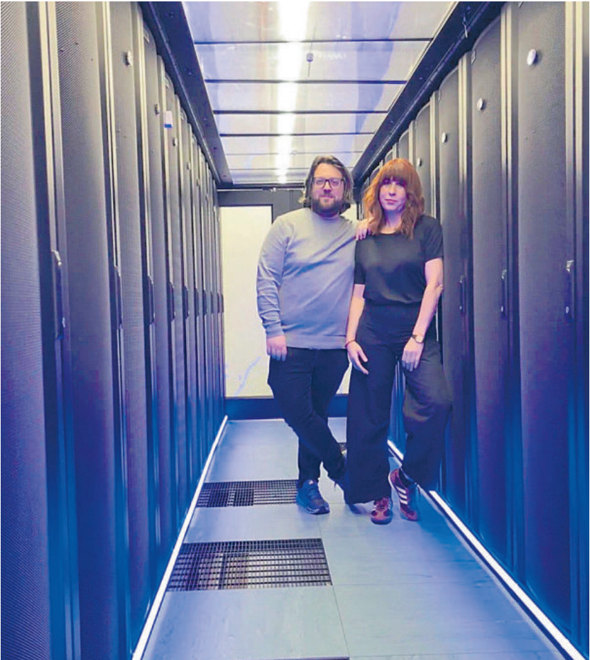
Técnicos de la Red de Ciencia y Tecnología de Castilla y León (RedCAYLE) en el interior del CPD de SCAYLE. LNC
