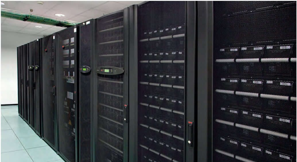
Sistema de Alimentación Ininterrumpida de Caléndula. © SCAYLE.
